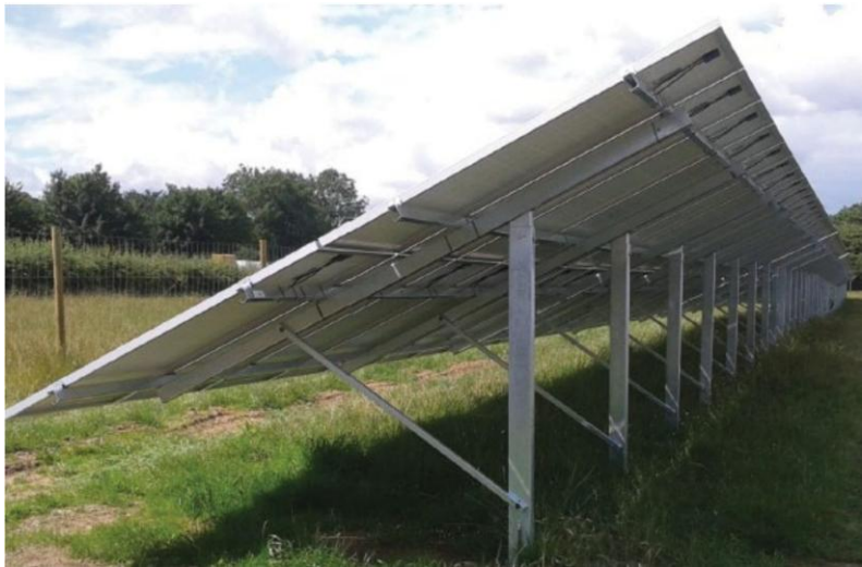
Figure 1 : Illustration des structures photovoltaïques (Source : ESCOFI)
