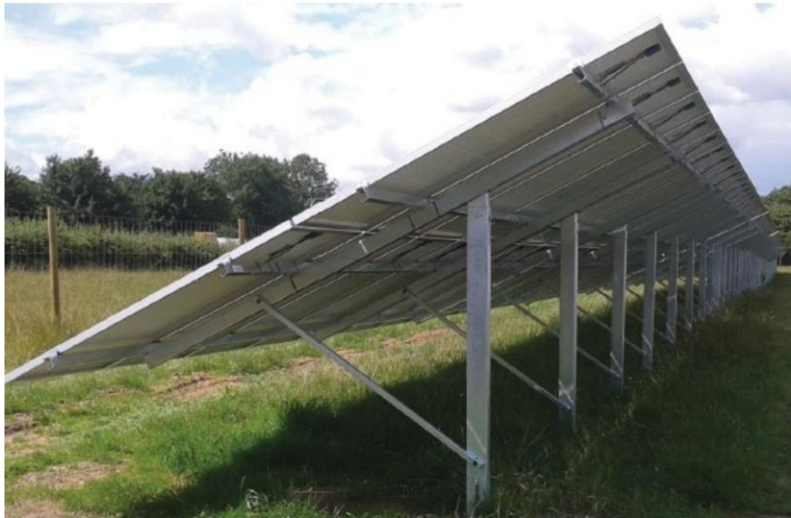
Figure 7 : Illustration des structures photovoltaïques (Source : ESCOFI)
