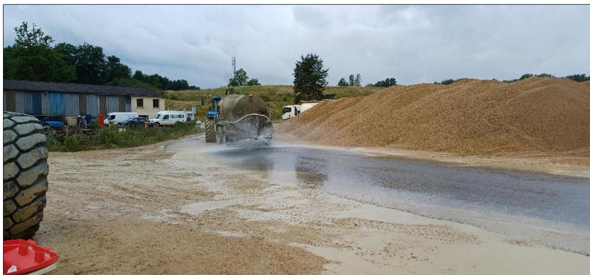
Figure 14 : Arrosage des pistes avec les eaux pluviales provenant du bassin
