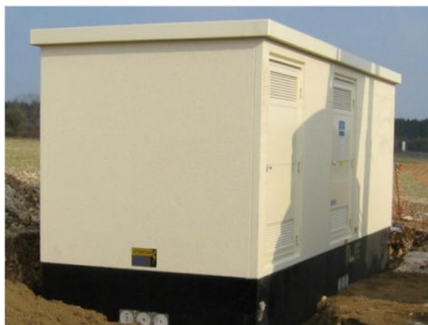
Figure 4 : Photo d'un poste de livraison (Source : SUNPOWER)
