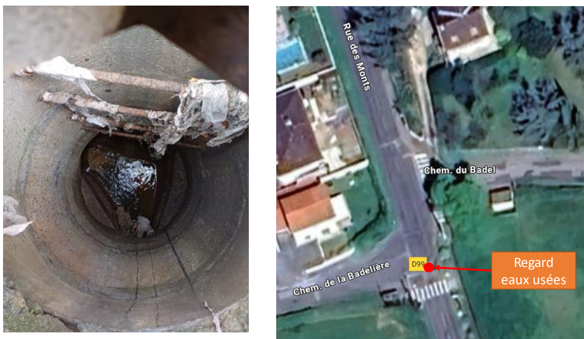
Figure 23 : Mise en charge du regard d'eaux usées sur le croisement chemin du Badel
