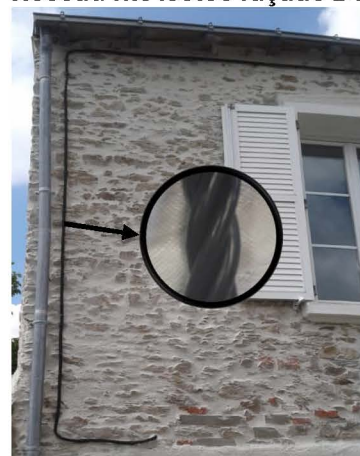
Réseau fils isolés façade BT
