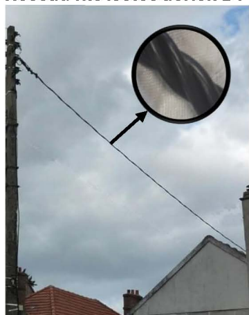
Réseau fils isolés aérien BT
