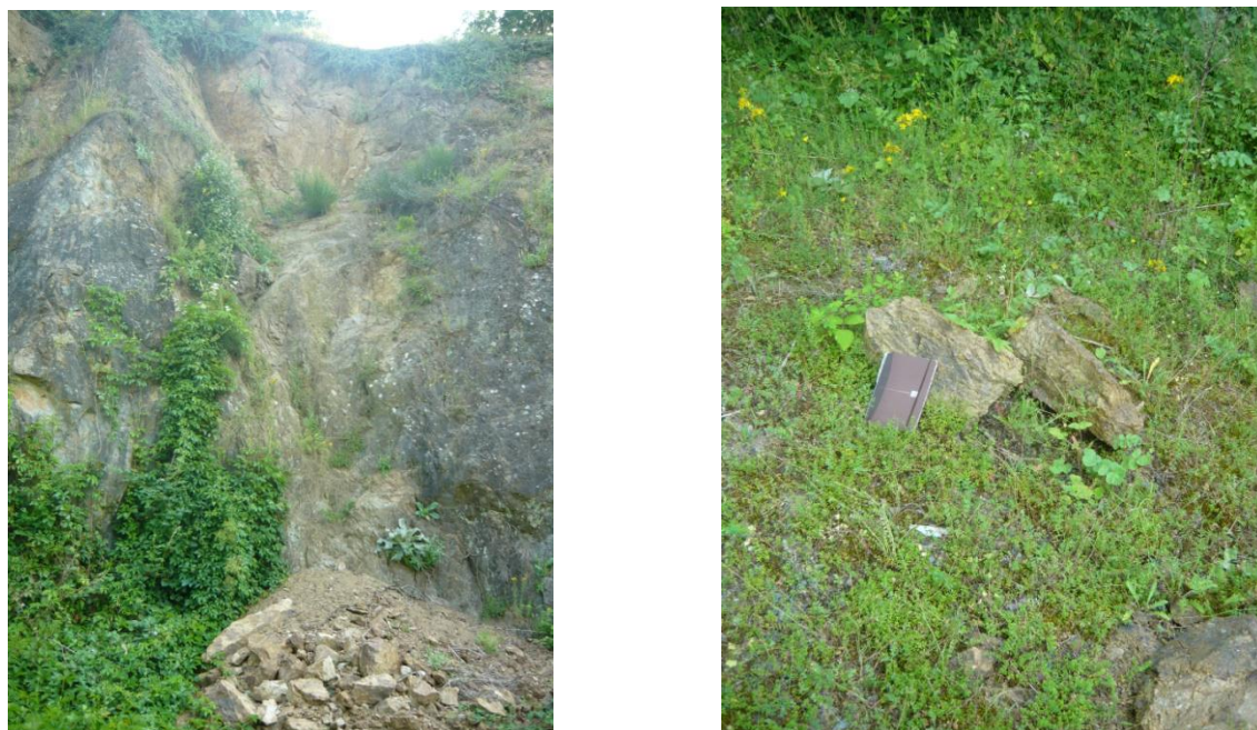
Figure 6: zone éboulée sur la partie Est du front rocheux (gauche) ; chute de blocs arrêtée par le merlon sur la partie Est du front rocheux (droite)
