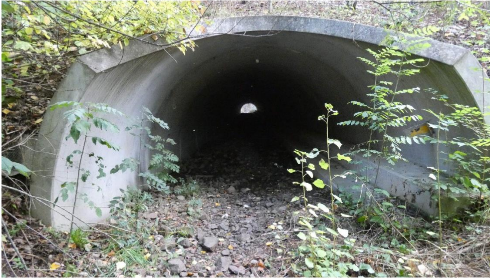
Le passage à faunes sous l'A89 L 4m h 2m
