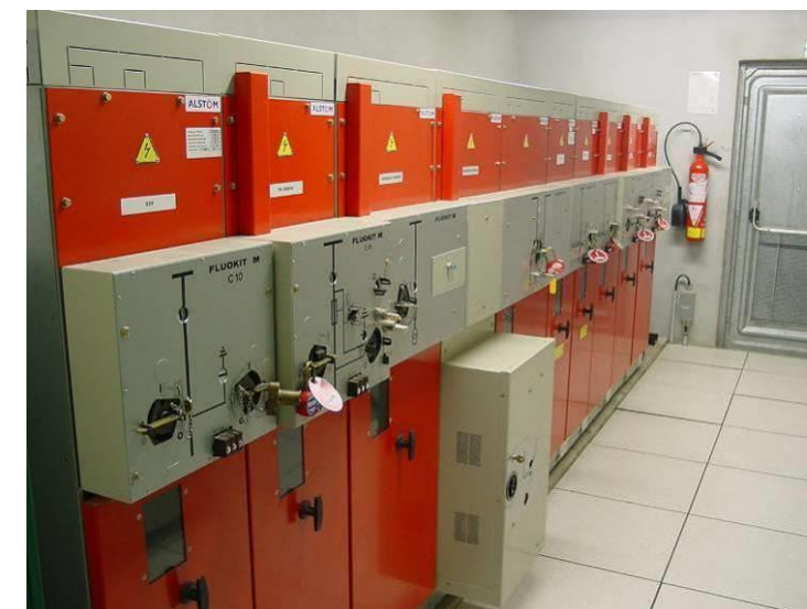
Illustration 10 : Intérieur d'un poste de livraison
