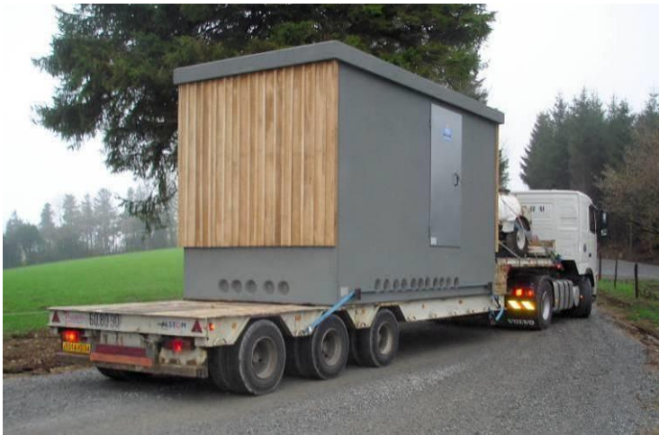
Illustration 11 : Arrivée d'un poste de livraison sur un site éolien
