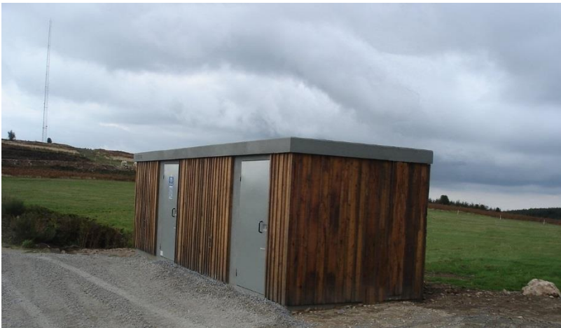
Illustration 12 : Poste de livraison du parc éolien du MARGNES (81)
