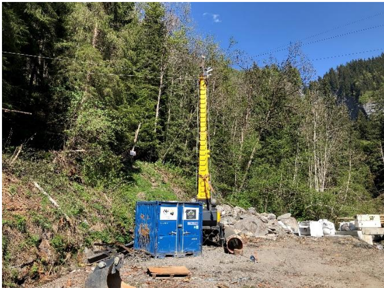
Figure : Photo illustrant un pylône de départ – Source : B.PILOT
