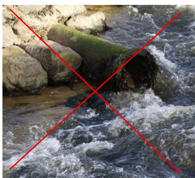
Sortie des eaux en rivière par tuyau
