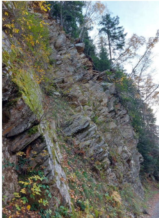
Figure 60. conduite forcée du Grand Nant : vue de la falaise dominant la route
