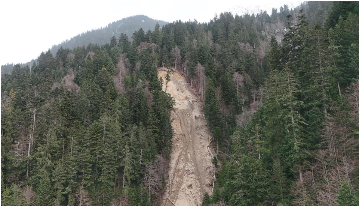
Figure 6. vue par drone de la niche d'arrachement du Merderet de février 2026 (Source B. Pilot)
