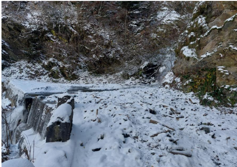
Figure 56. prise d'eau du Grand Nant : exemple d'accumulations hivernales de cailloux sur la voie
