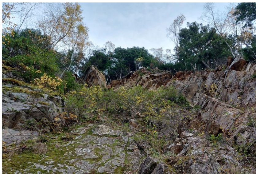
Figure 61. conduite forcée du Grand Nant : illustration des casquettes instables dominant la route
