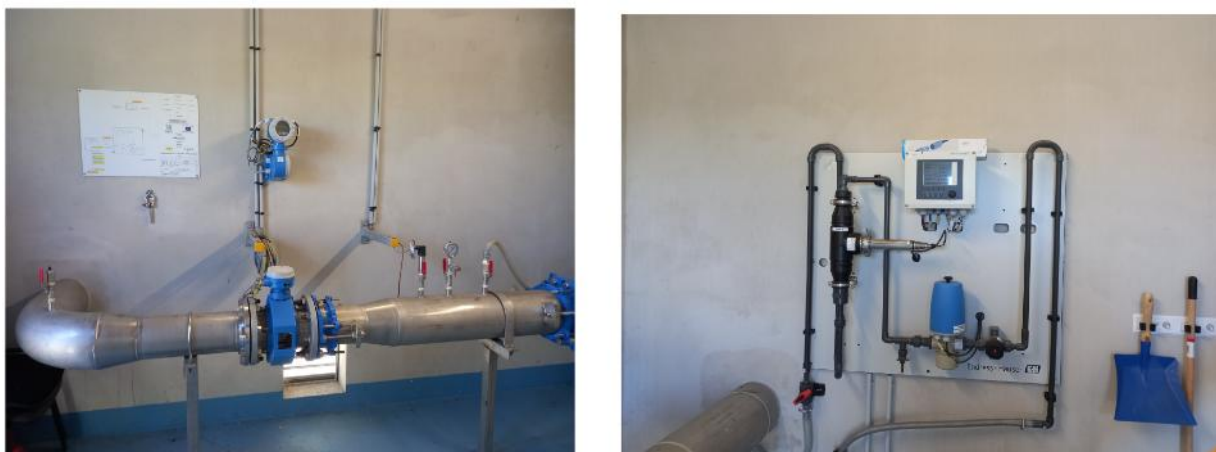
Figure 11 : Installation du matériel de mesure dans le local technique
