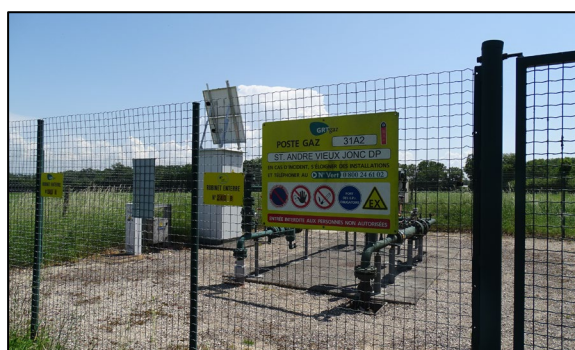
Poste de gaz à Chassignole
