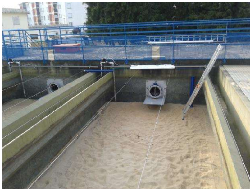
FIGURE 19 : EXEMPLE DE FILTRE A SABLE EN COURS D'ENTRETIEN
