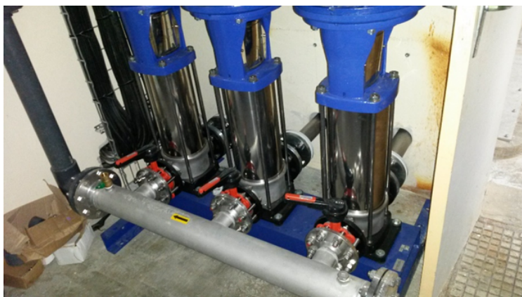
GROUPE DE SURPRESSION D'EAU DE SERVICE (POMPES MULTICELLULAIRES)
