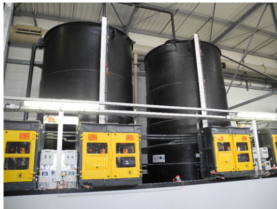
INSTALLATION DE STOCKAGE/DOSAGE DE RÉACTIFS LIQUIDE -MERVENT (85)
