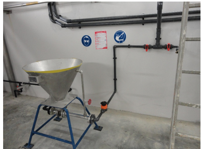
INSTALLATION DE STOCKAGE ET DOSAGE DE MICROSABLE
