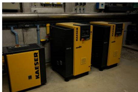
GROUPE DE PRODUCTION D'AIR DE SERVICE
