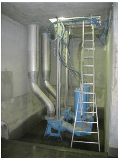
EXEMPLE POMPES EAU DE LAVAGE
