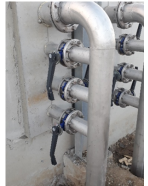
VANNES EVACUATION DES EAUX CLAIRES
