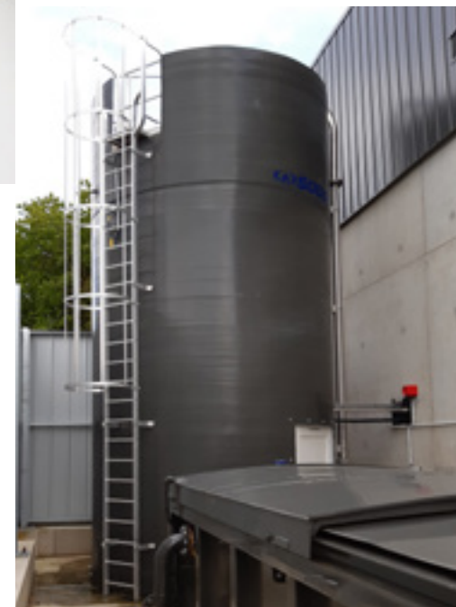
Silo de stockage et benne filtrante de micrograin
