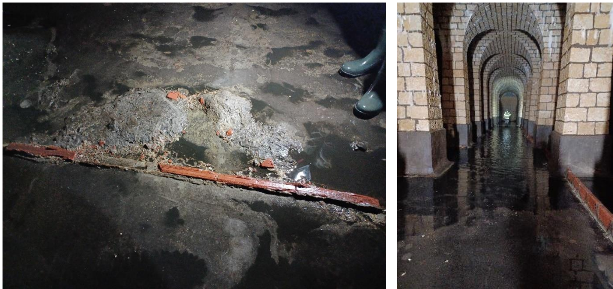
Figure 20 : Etat du radier dans les cuves
