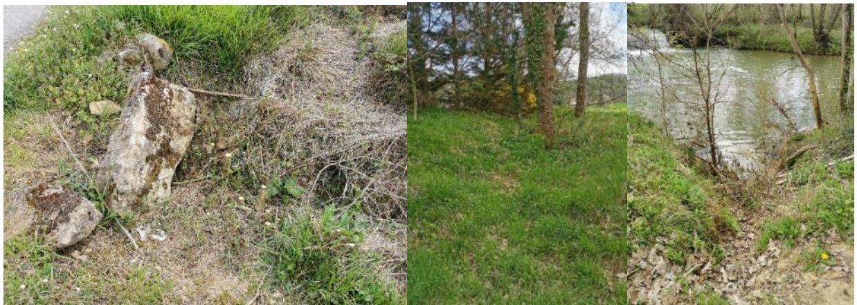
Photos 41 à 43 : Absence de protection au niveau de la route (41) traversant le petit fossé, très peu marqué voire absent (42) sur une partie de son linéaire, et débouchant sur le Gers (43).
