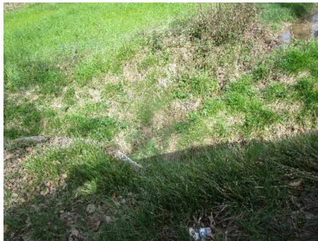
Photo 57 : Route traversant un affluent du ruisseau, sans mesure de protection efficace contre le ruissellement provenant de celle-ci vers le ruisseau malgré la présence d'une couverture herbeuse.
