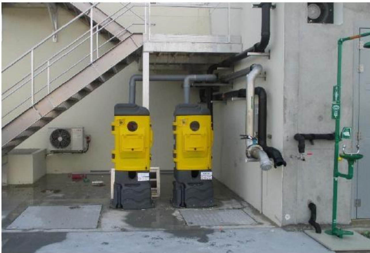
Figure 59 : Exemple de coffrets de dépotage avec douche de sécurité à proximité
