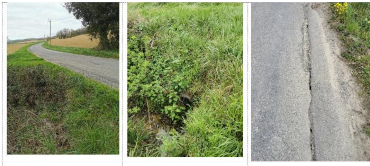
Photos 15 à 17 : De gauche à droite point à risque, passage du cours d'eau sous la route et état de l'enrobé.
