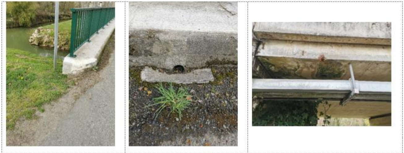
Photos 27 à 29 , de gauche à droite l'angle vulnérable du pont, un des trous partant sous le trottoir du pont en traversant le pont, la sortie d'un de ces trous sur le Gers
