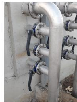
VANNES EVACUATION DES EAUX CLAIRES
