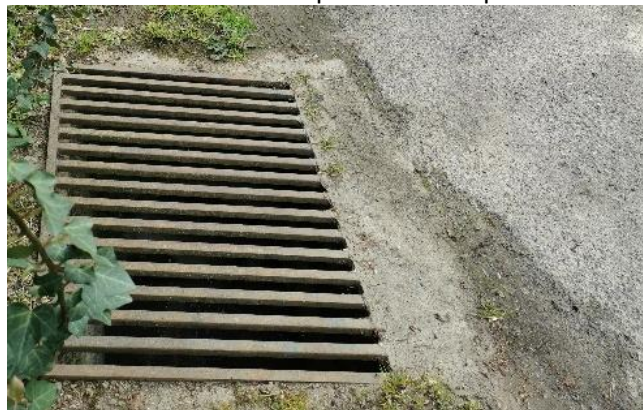
Photo 32 : Avaloir à proximité du Gers au niveau du point 9
