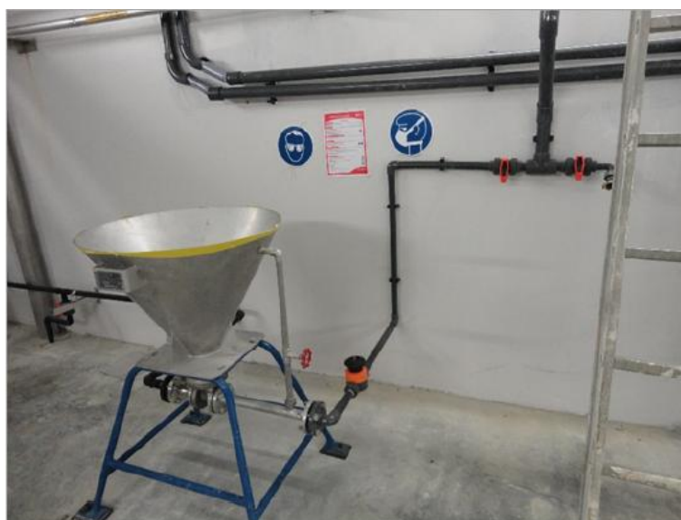
Figure 43 : Installation de stockage et dosage microsable
