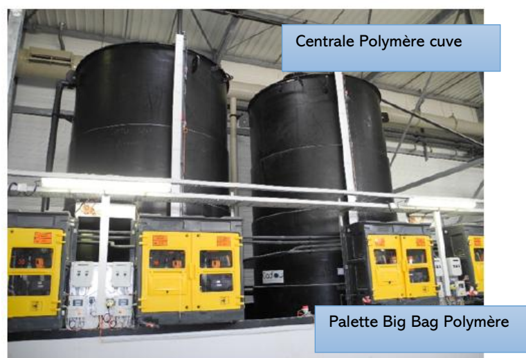
Figure 41 : Installation de stockage / dosage de réactifs liquide - Exemple de l'usine de Mervent (85)
