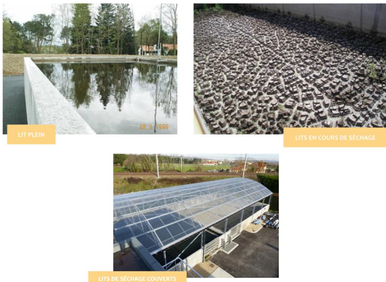
Figure 47 : Installations de lits de séchage des boues aux différentes phases du traitement
