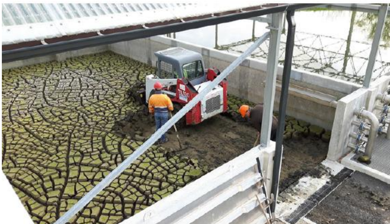
Figure 55 : Exemple de curage d'un lit de séchage
