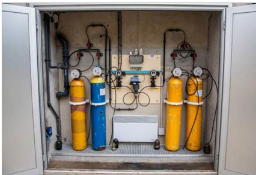
Figure 45 : Exemple de local pour le stockage du chlore
