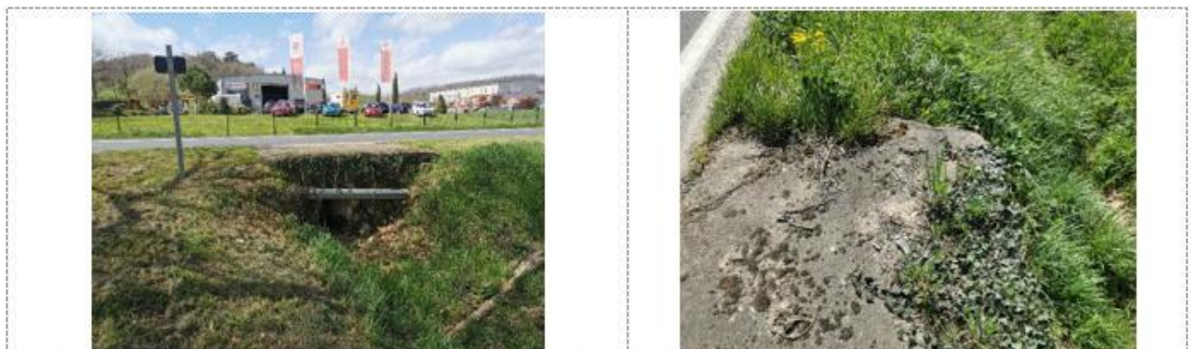
Photos 44 et 45 : Départementale passant au-dessus d'un fossé, sans dispositif empêchant les écoulements de rejoindre le fossé. Présence d'une dalle béton favorisant le ruissellement des deux côtés de la route.
