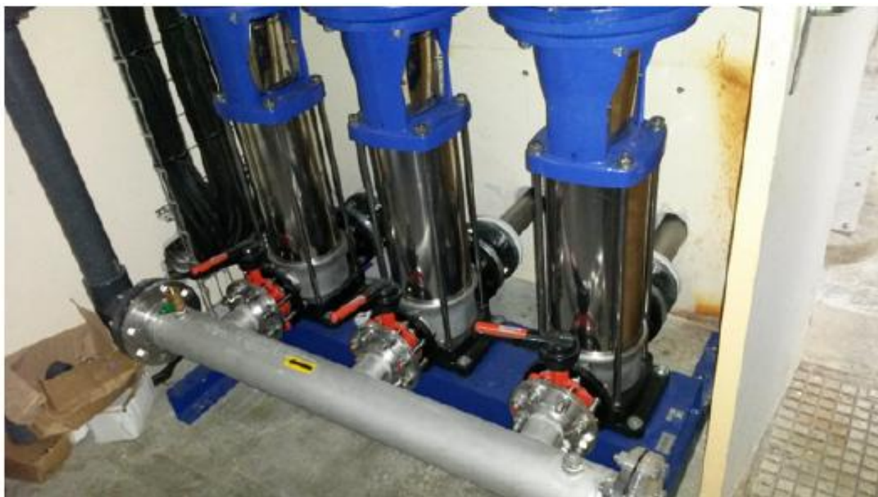
Figure 56 : Groupe de surpression d'eau de service (pompes multicellulaires)
