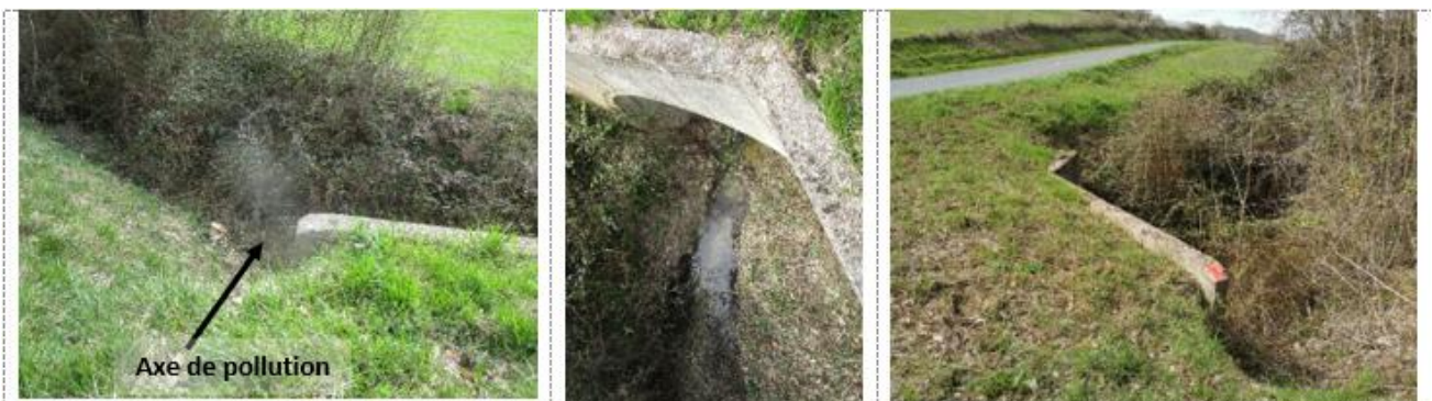
Photos 54 à 56 : Route traversant le ruisseau du Hay, sans mesure de protection efficace contre le ruissellement provenant de celle-ci vers le ruisseau malgré la présence d'une couverture herbeuse (amont en 54 et 55 et aval en 56).
