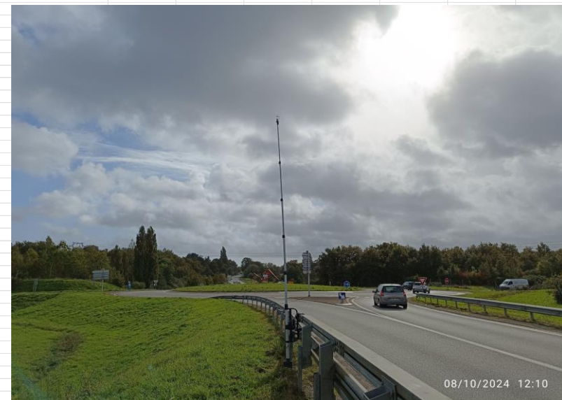
Photo(s) du matériel posé
