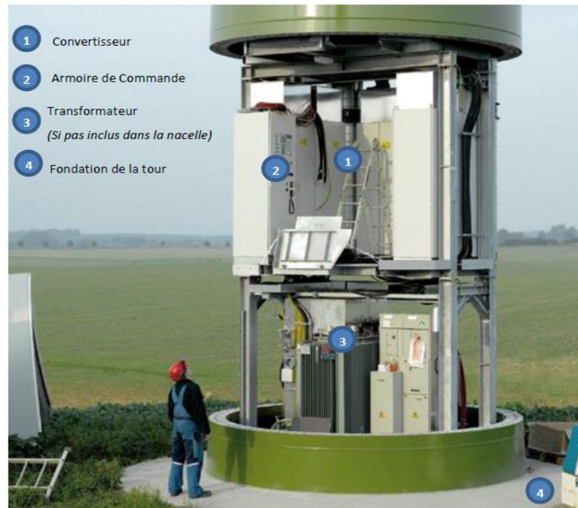
Transformateur inséré dans le mât (Enercon)
