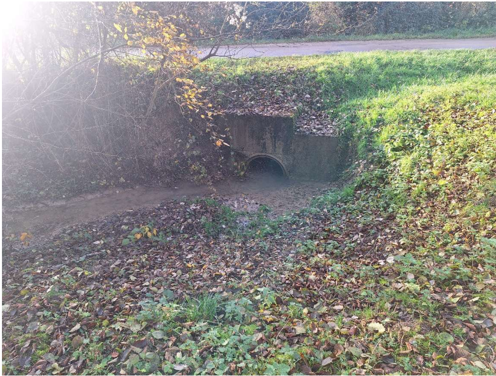
Dépression et buse de décharge. Source : CD89.
