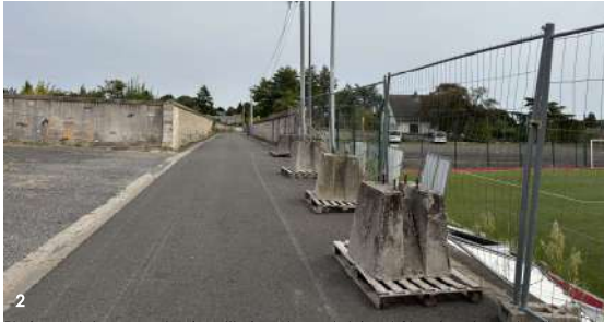
Plusieurs m de mur sont aujourd'hui par terre et doivent être réparés par la ville
