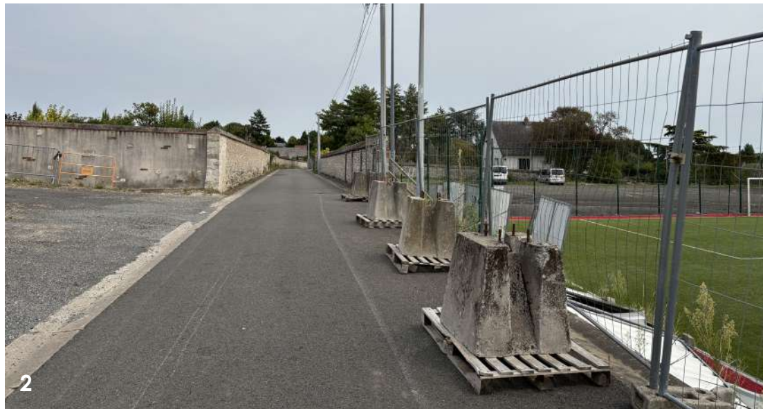
Plusieurs ml de mur sont aujourd'hui par terre et doivent être réparés par la ville
