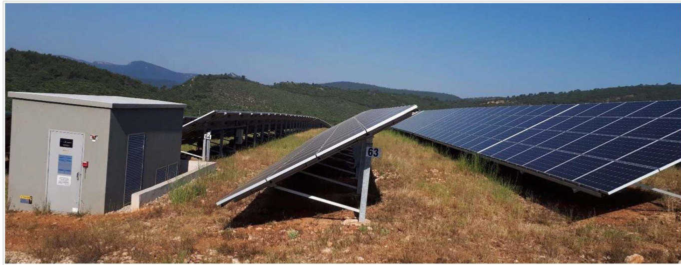
Exemple de support fixe (Source : Auddicé environnement)
