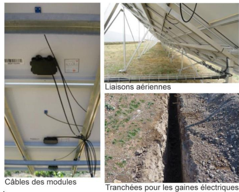
Photographie 5 : Liaisons électriques (Source : ENCIS Environnement)
