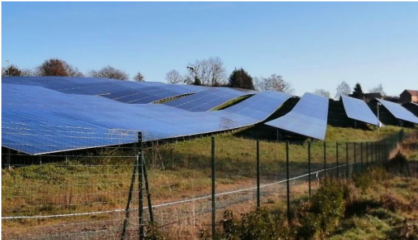
Photographie 1 : Exemple d'installation photovoltaïque au sol (Source : ENCIS Environnement)
