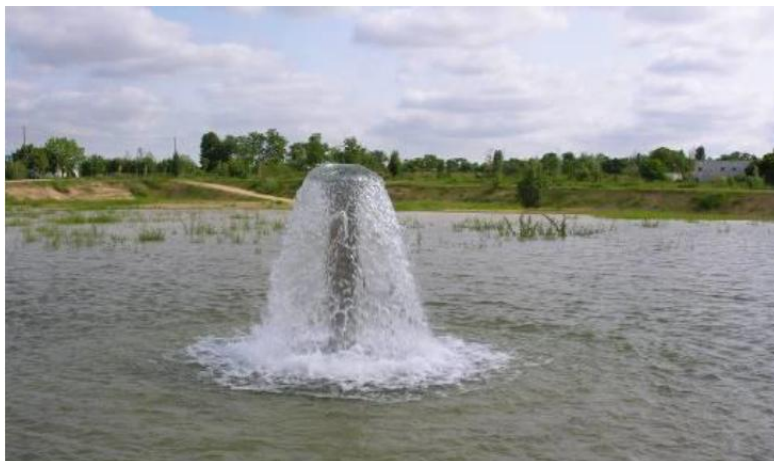
Figure 6 : Exemple d'arrivée d'eau en tulipe (Source : APD, Suez Eau France)
