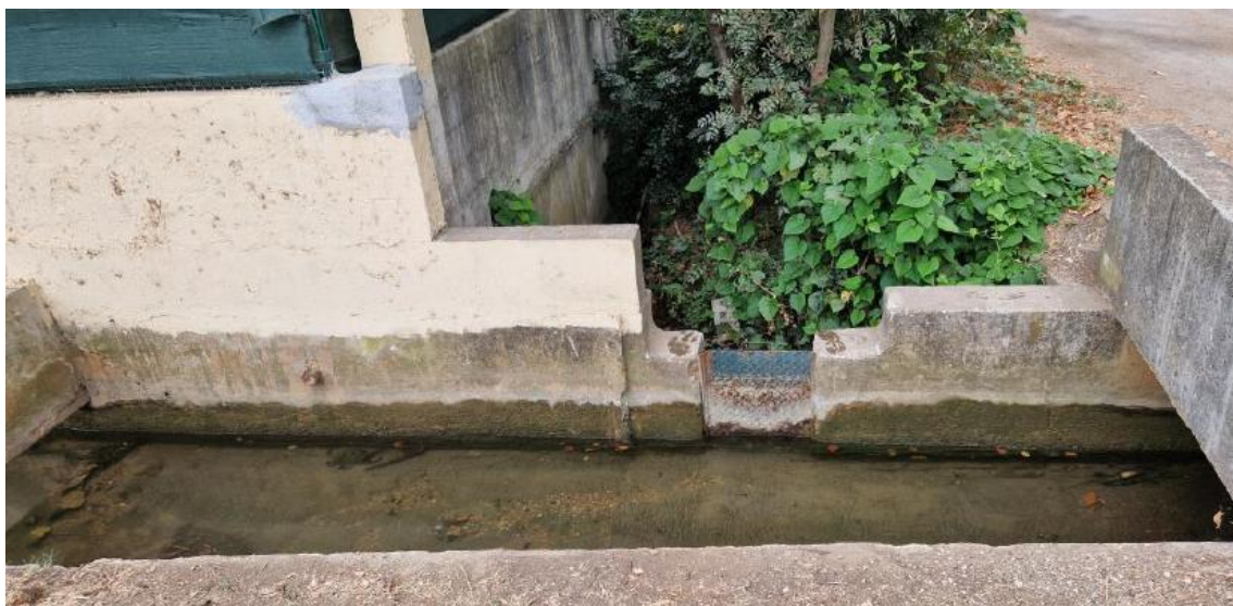
Figure 163 : Photo de la martelière du point 4 (SONDALP, 2025)
