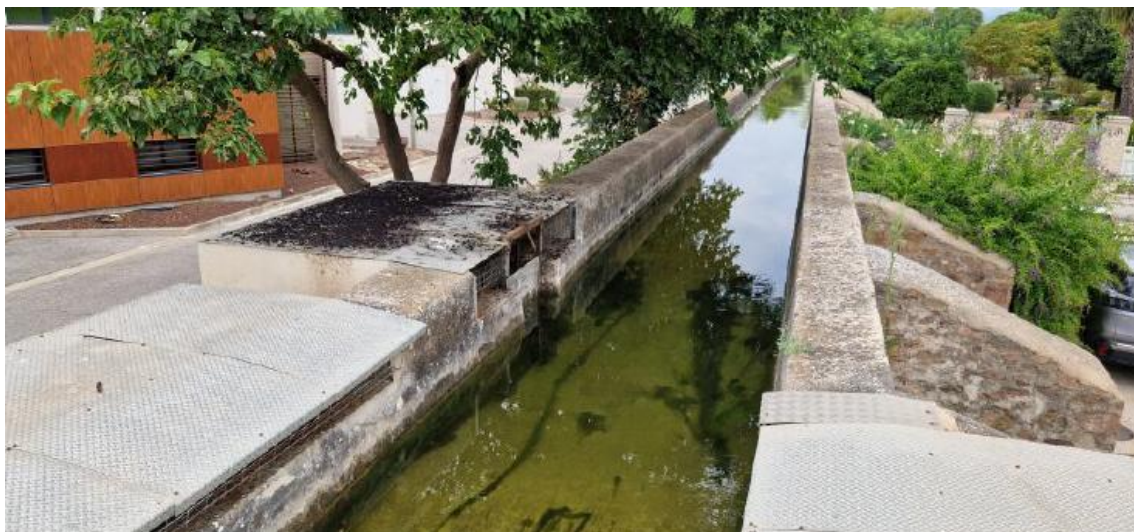
Figure 162 : Photo de la martelière du point 3 (SONDALP, 2025)
