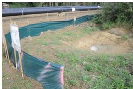
Exemple de bâche anti-intrusion (photo : C. Juhel)
