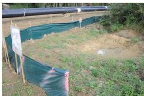
Exemple de bâche anti-intrusion (photo : C. Juhel)
