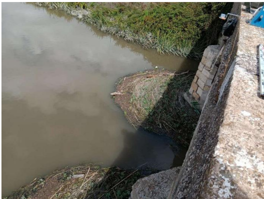
Figure VI-10 : Point de mesure GPMM10 - Embâcles visibles suite à l'évènement du 21 septembre 2025
