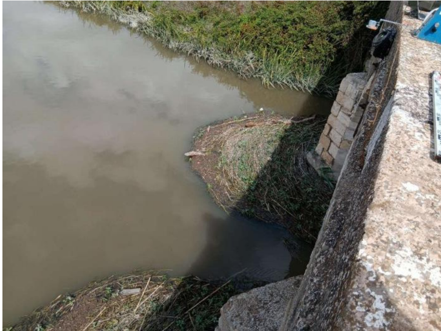
Figure III-10 : Point de mesure GPMM10 - Embâcles visibles suite à l'évènement du 21 septembre 2025
