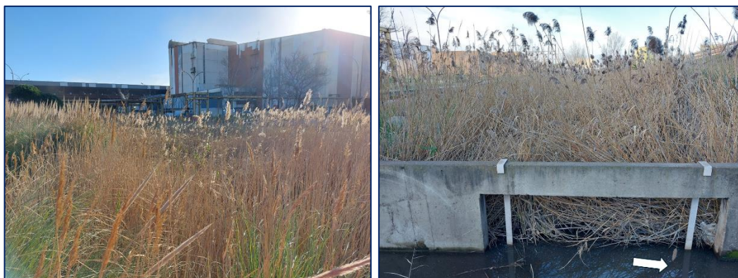
Figure 13 : Bassin de rétention au niveau de l'aciérie (photo de gauche) et liaison aval avec la roubine de l'aciérie (photo de droite)
