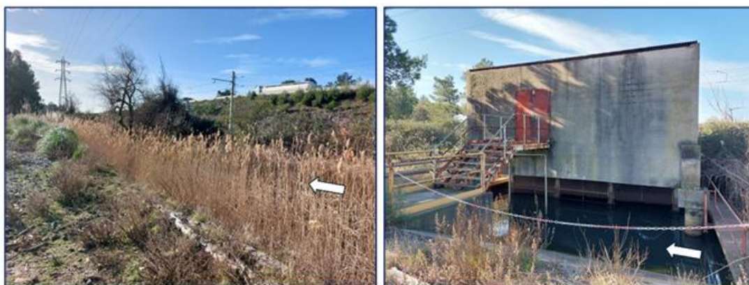
Figure 288: Roubine de la voie ferrée (photo de gauche) et station de pompage (photo de droite)
