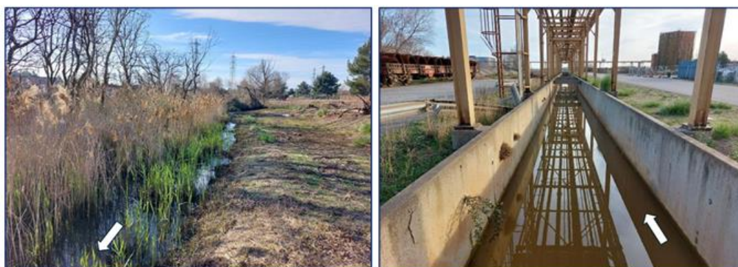
Figure 287: Roubine principale sur sa partie amont (photo de gauche) et sur sa partie aval (photo de droite)
