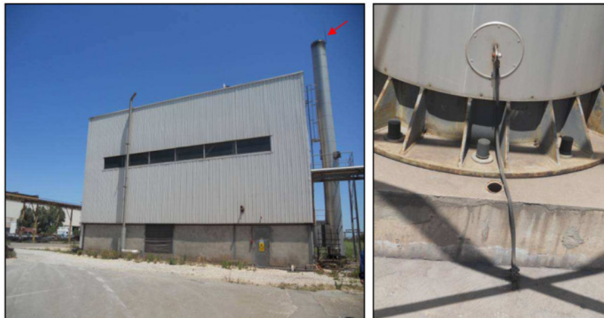
Pointe de choc sur cheminée de la chaudière et mise à la terre
