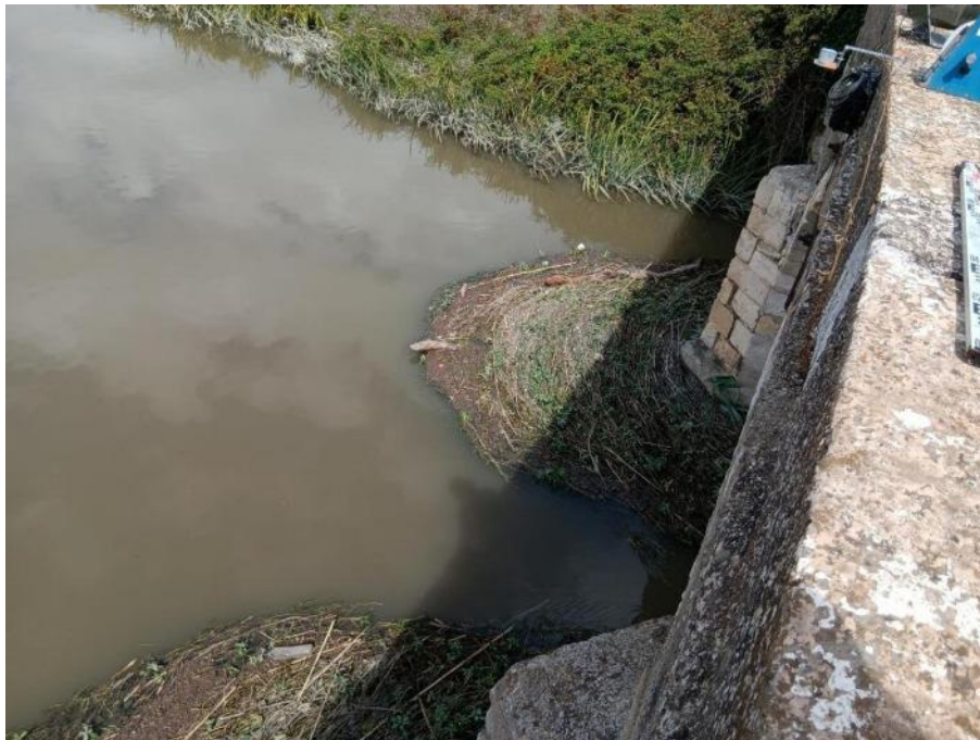
Figure 15 : Point de mesure GPMM10 - Embâcles visibles suite à l'évènement du 21 septembre 2025
