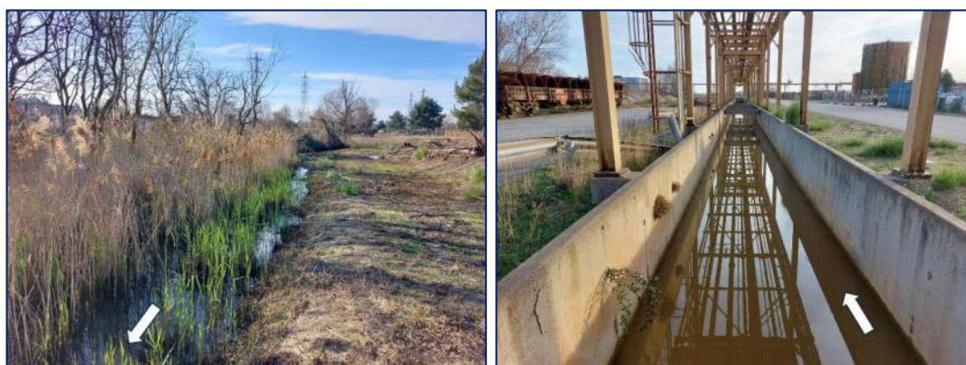
Figure 7 : Roubine principale sur sa partie amont (photo de gauche) et sur sa partie aval (photo de droite)
