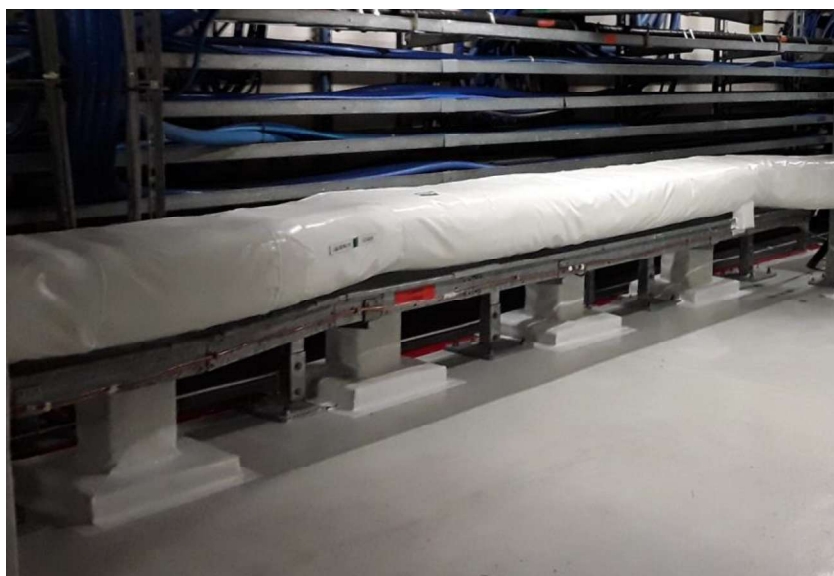
Figure 4. Exemple de protection de chemin de câbles
