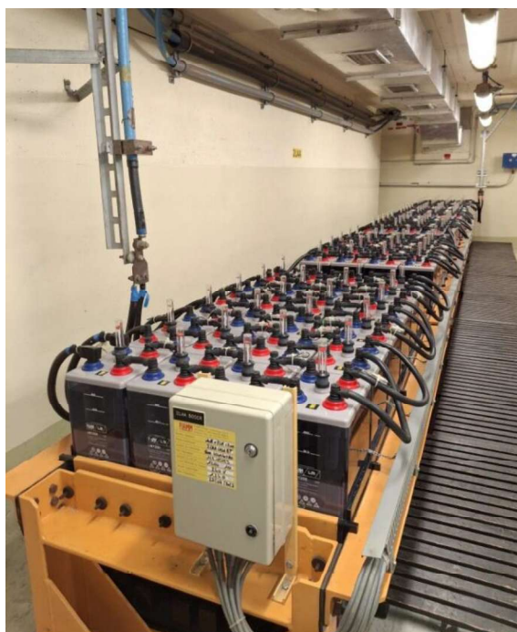
Figure 6. Photo des locaux contenant les batteries
