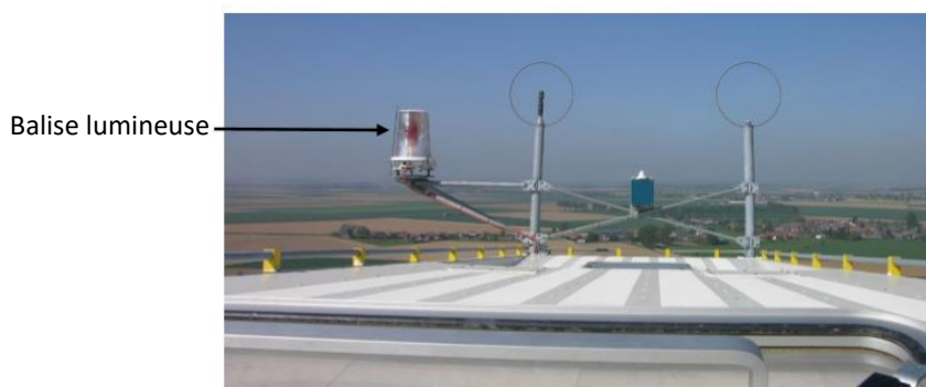
Figure 22: Système de balisage lumineux (Source : ECOTERA)
