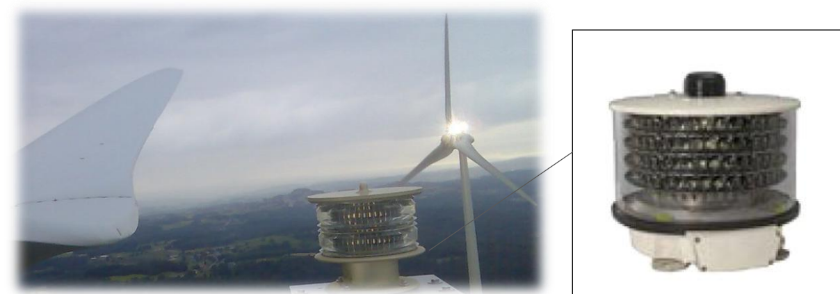
Figure 52 : Balisage d'une éolienne
