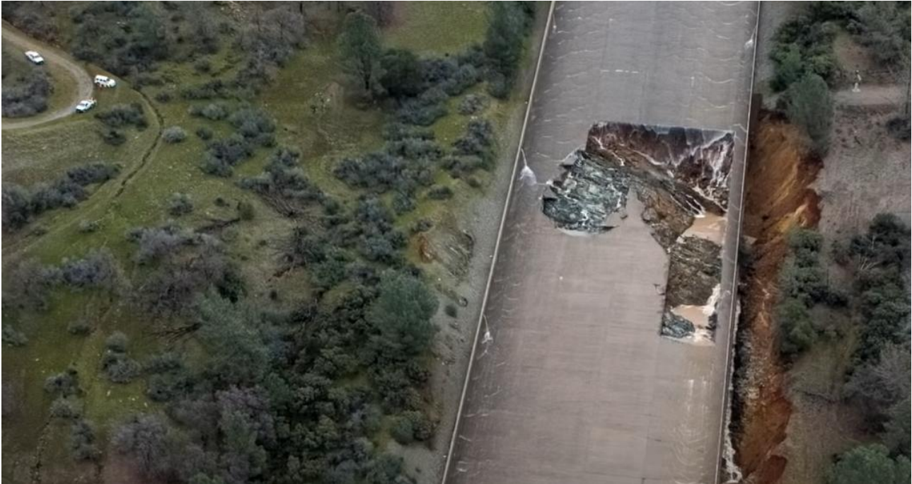
Figure 18 : Endommagement du coursier de l'évacuateur du barrage d'Oroville (source FERC)
