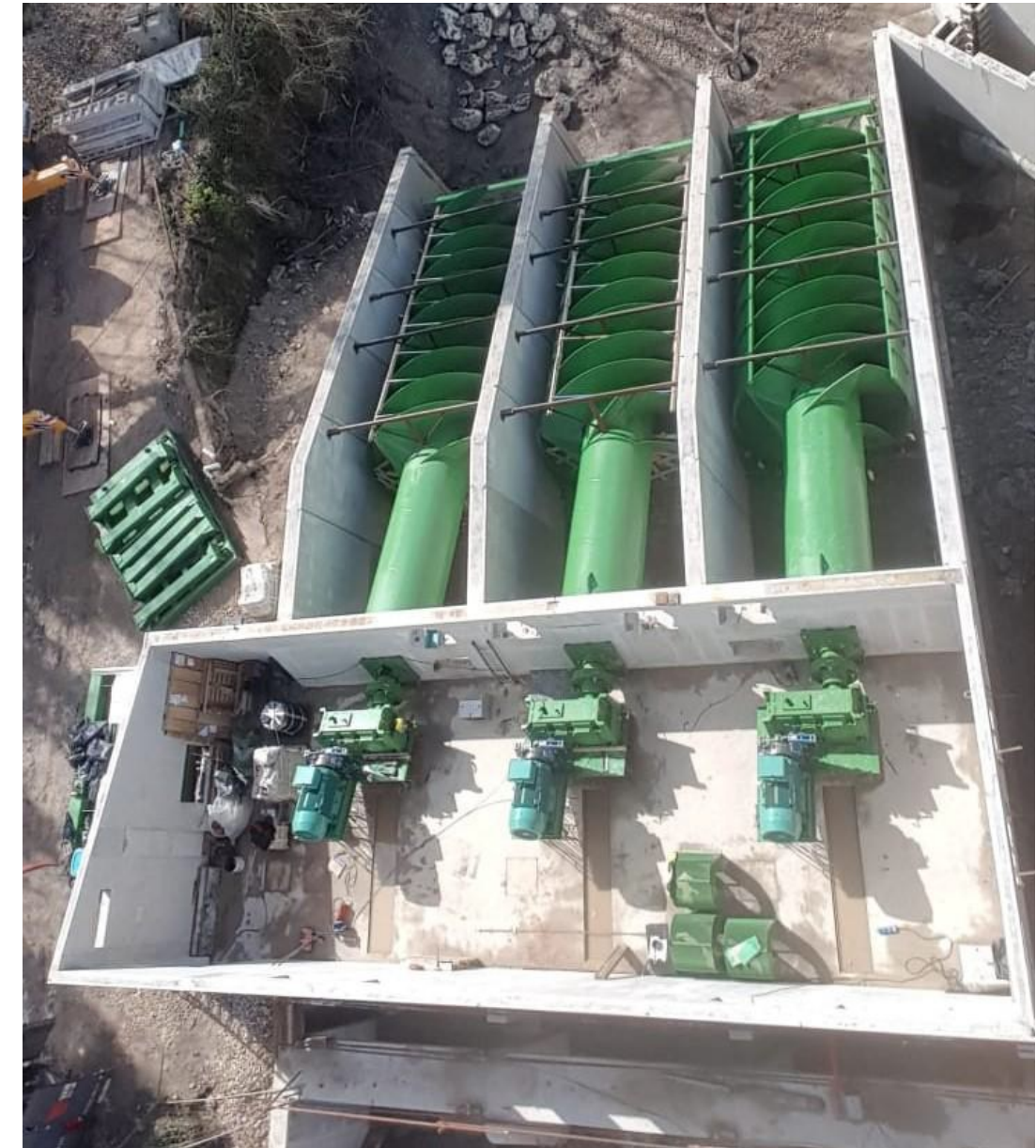
Figure 15 : Installation composée de 3 vis hydrodynamiques
