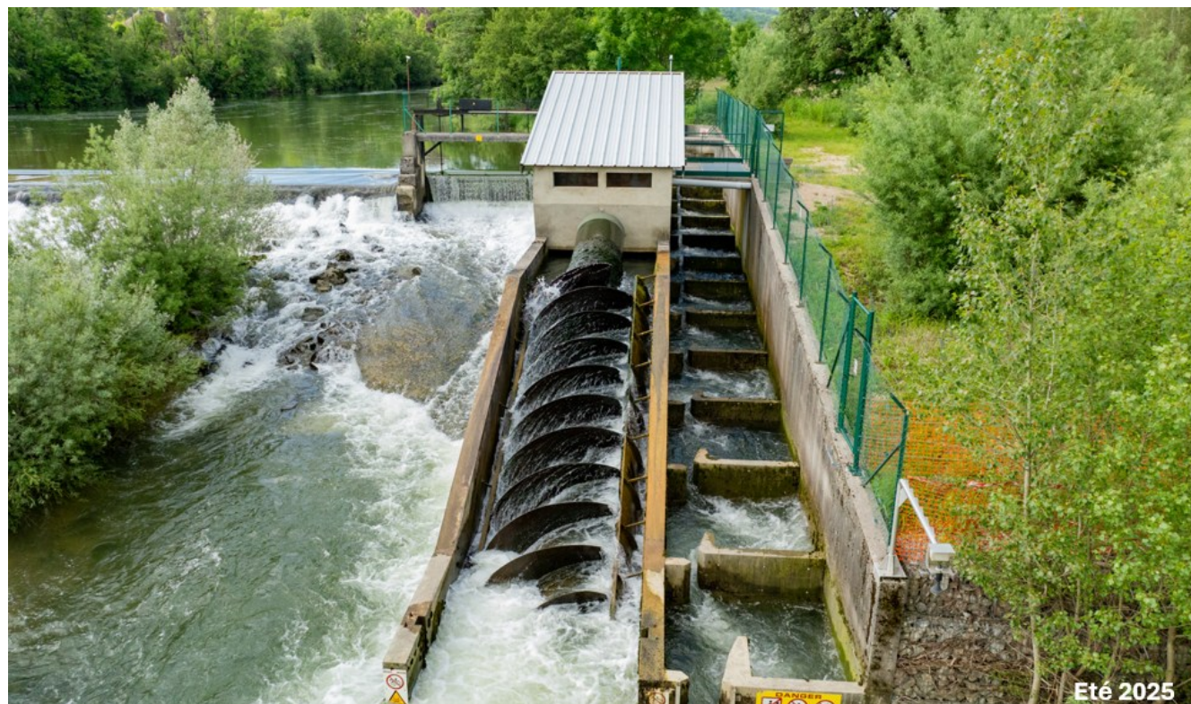
Figure 14 : Vis hydrodynamique réalisée par Nouvergies sur la centrale de Pont-du-Navoy
