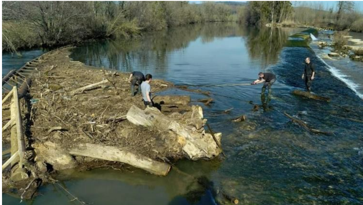
Figure 44 : photo de la drome actuellement installée à l'entrée du canal d'amené et les contraintes de nettoyage des embâcles
