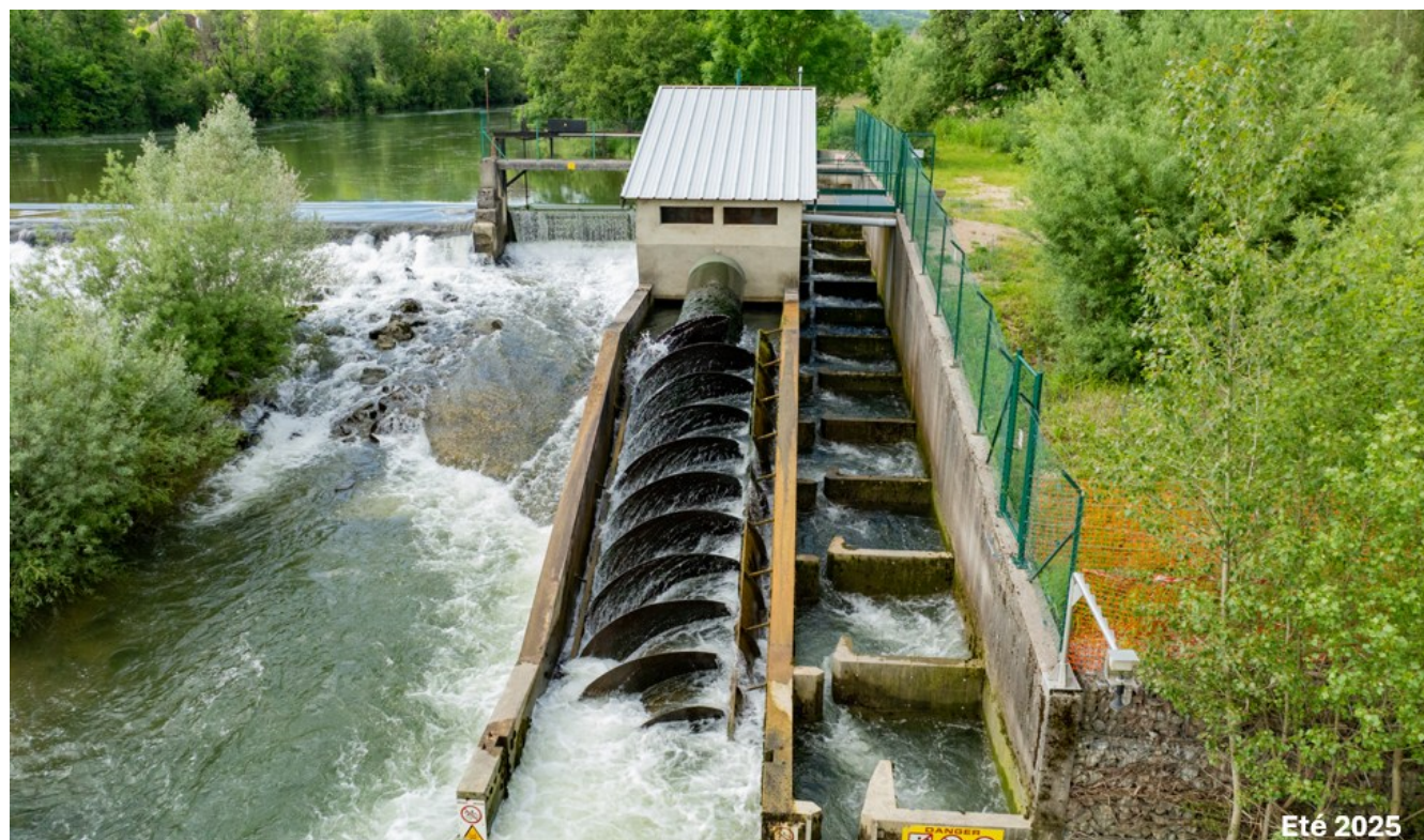
Vis hydrodynamique réalisée par Nouvergies sur la centrale de Pont-du-Navoy
