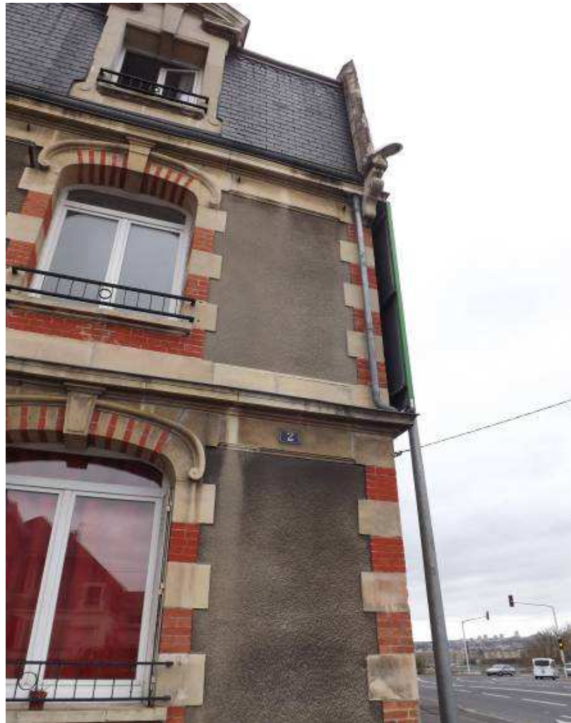
Exemple de dispositif dépassant les limites du mur pignon de l'immeuble
