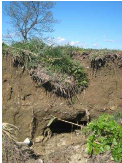
Figure 6-12 : Dignes de l'Agly – Erosion de talus et débouché du fontis (source : ISL)
