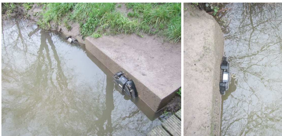
Figure 7-28 : clapets n°3 et 4 – clapet n°5.
