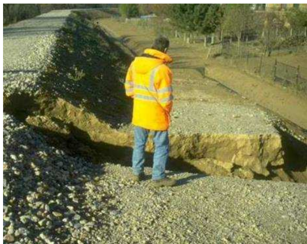
Figure 6-13 : Renard le long d'une conduite sur la digue de Cuxac-d'Aude lors de la crue de novembre 1999 (source :IRSTEA), ayant occasionné un écoulement de plusieurs centaines de litres secondes à travers la digue - brèche en cours de formation
