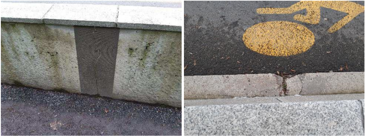
Figure 7-8 : illustration des fissurations observées.
