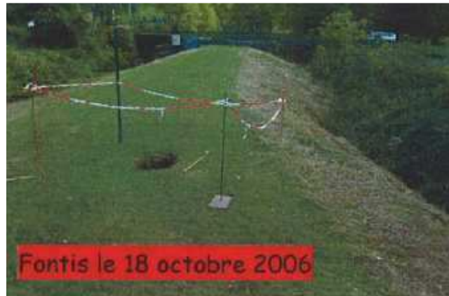
Figure 6-15 : Fontis dans la digue de la station INRA de Saint Pée sur Nivelles (source : ISL)
