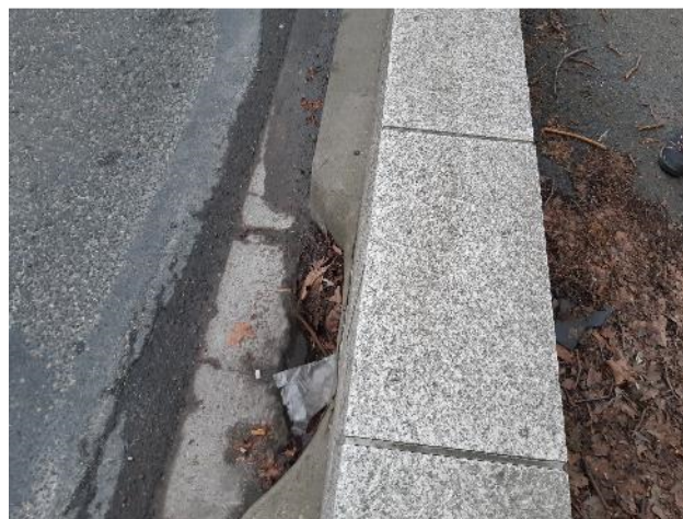
Figure 7-32 : avaloir en pied de murette.
