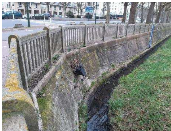
Figure 7-47 : Ouvrage traversant relevé sur le Boulevard A. Briand
