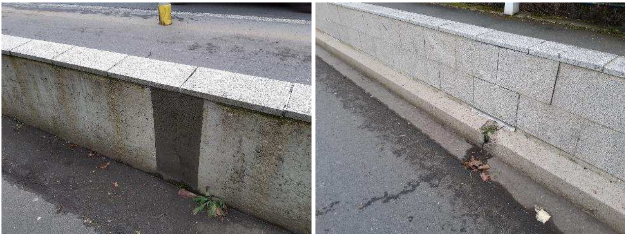
Figure 7-16 : illustration des fissurations observées.
