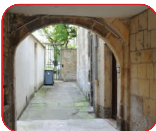
● Cour en ciment, revêtement inapproprié.
