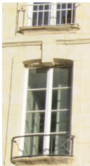
Garde-corps inférieur incomplet et supérieur non cohérent.
