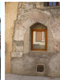
Figure 140 : Rénovation peu respectueuse de l'ouverture originelle, Chorges
