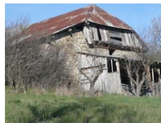
Figure 138 : Abandon et dégradation du patrimoine bâti, Puy Saint Eusèbe, Peyre Grosse.
