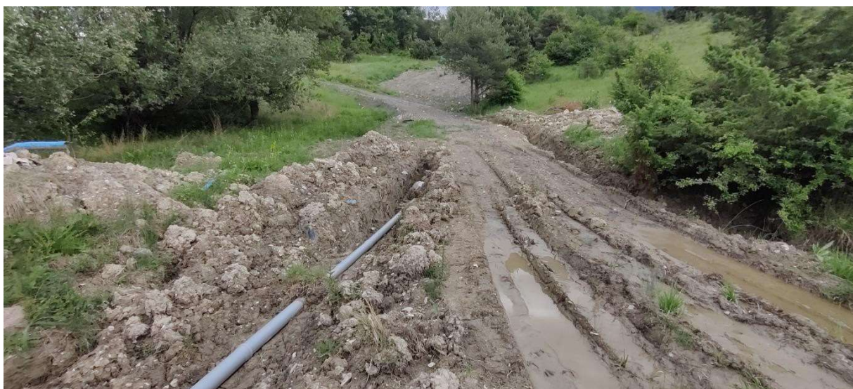
FIGURE 31: REMBLAIS, DRAINS ET CANALISATIONS RECENTS (2024) SUR UNE ZONE HUMIDE ET UNE MARE A SONNEUR A VENTRE JAUNE. COMBE MASSE (SAINT-ANDRE-D'EMBRUN)
