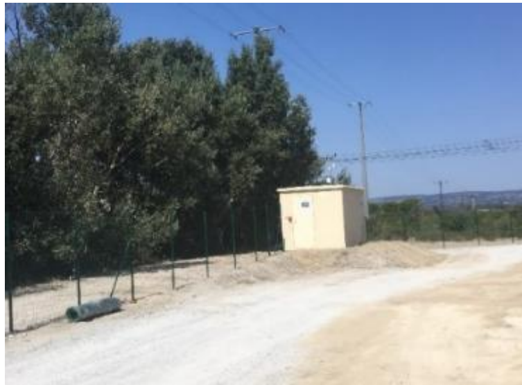
Illustration 47 : Exemple de poste de livraison
