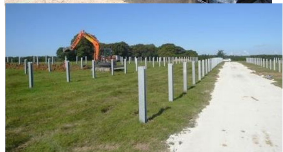
Poste des structures porteuse
