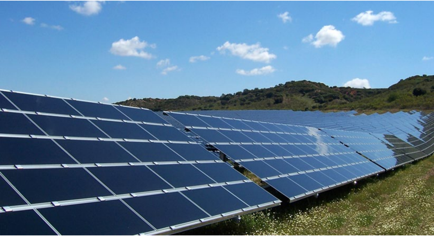
Parc photovoltaïque EDF Renouvelables de Narbonne
