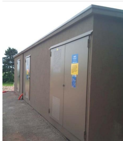
Figure 58 : Exemple de poste de livraison
